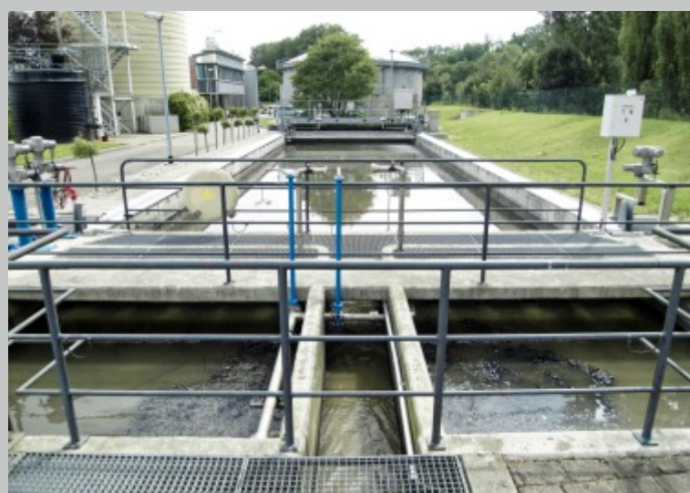
Zulauf und Vorklärung
